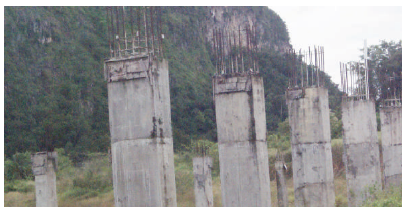
Tiang bangunan yang ditinggal terbengkalai.
