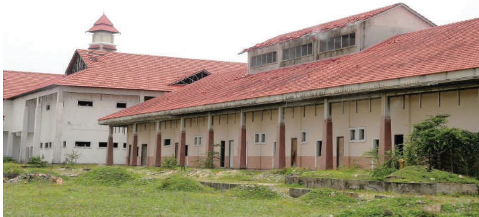
Sebahagian bangunan di kompleks Taman Ilmu Terengganu yang terbiar dan mengalami kerosakan.
